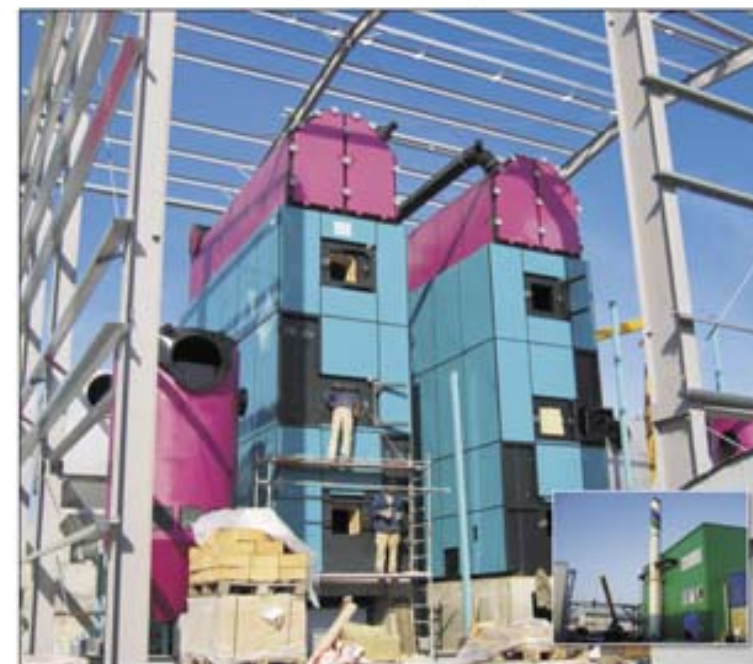
2 x 1.500 кВт топki с гидравлическими механическими колосниковыми решетками
