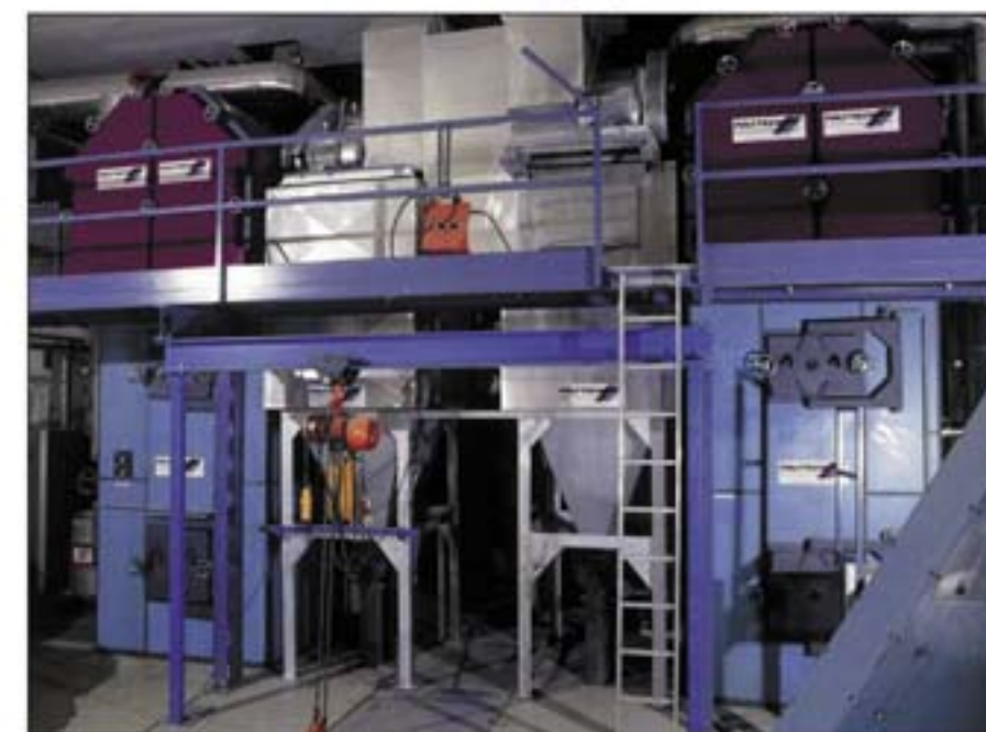
2 x 1.500 кВт топки с гидравлическими механическими колосниковыми решетками
