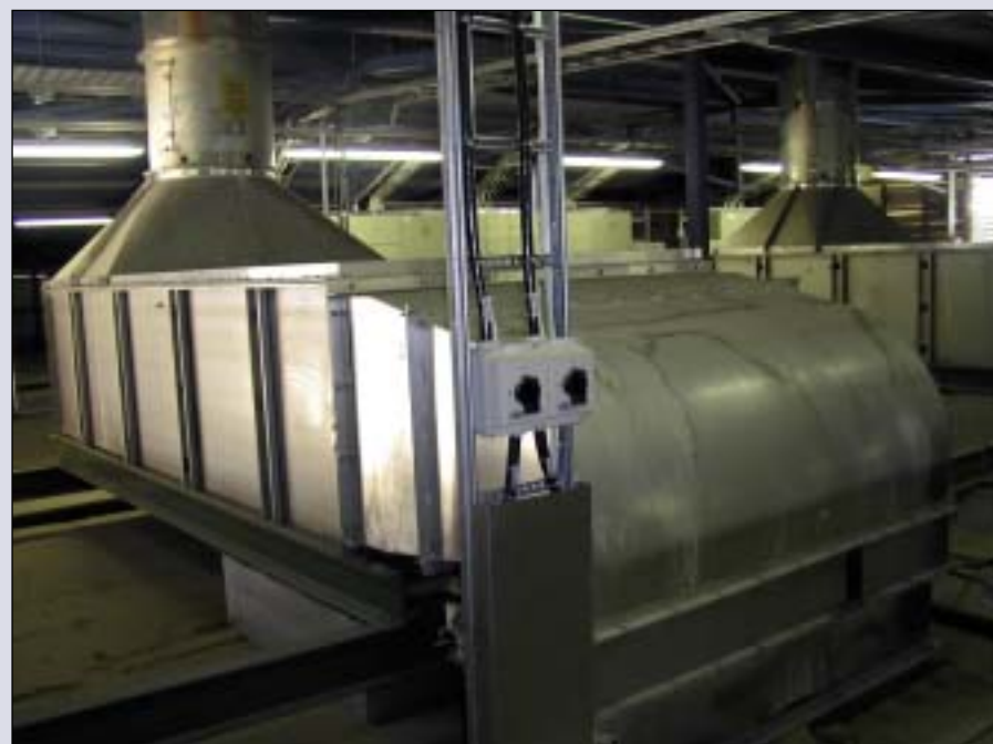
Фото 3. Тепловые рекуператорные установки
