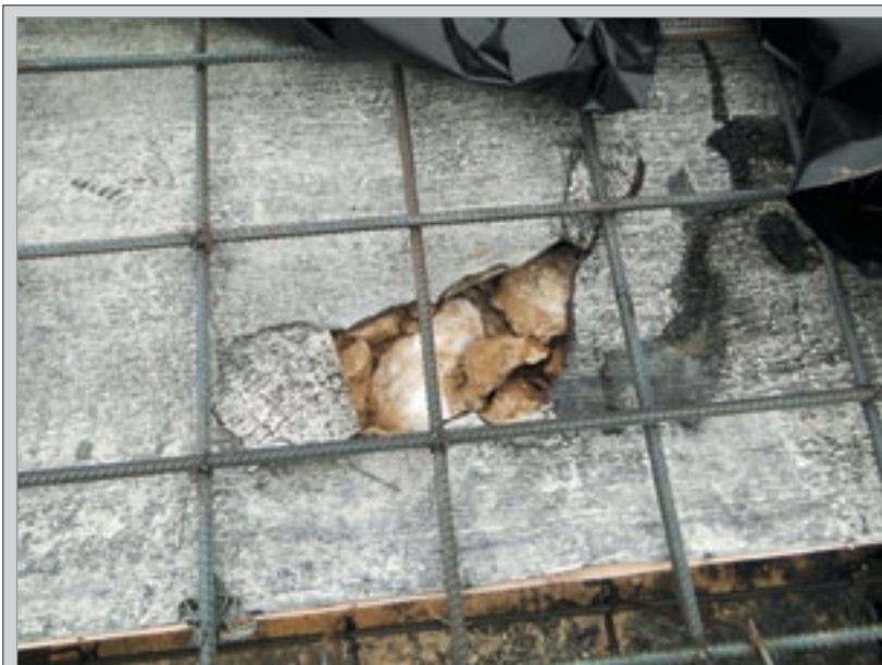
При обследовании установлено, что армирование монолитной плиты каминя выполнено на подсыпке из песка толщиной 100 мм
