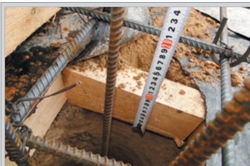
Не выполнены требования ВСН 29-85 «Проектирование мелкозаглубленных фундаментов малоэтажных сельских зданий на пучинистых грунтах». Это приведет к значительным деформациям грунтов основания под действием сил морозного пучения, а также к деформациям конструкций фундаментов индивидуального жилого дома из клееного бруса, деформациям и повреждению конструкций каминя и ухудшению его эксплуатационных свойств
