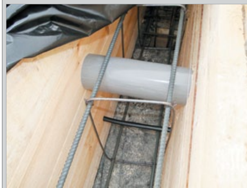
Основные недочеты и нарушения, которые были выявлены в результате экспертизы, возникли из-за низкой квалификации рабочих, ошибок подрядчика при выполнении работ по выносу проектных отметок, установке опалубки и арматурных вязанных каркасов, а также из-за отсутствия контроля подрядчиком соблюдения требований, установленных в проектной документации и распространяющихся на объект требований нормативно-технической документации в процессе строительства индивидуального жилого дома из клееного бруса
