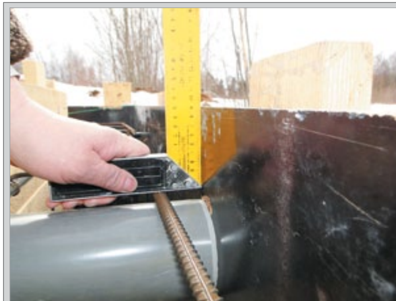
Не выполнено проектное требование к устройству защитного слоя толщиной 50 мм от верха ростверка до верха рабочей продольной арматуры. Он получился в 1,8 раза больше предусмотренного проектом, что значительно увеличивает материальные затраты по устройству фундаментов индивидуального жилого дома из клееного бруса. Пространственные вязанные арматурные каркасы ростверка не закреплены и «висят» на пластмассовых трубах сквозных вентиляционных отверстий в опалубке
