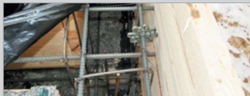
В процессе эксплуатации при отсутствии защитного слоя продольной и поперечной арматуры или его недостаточной толщине не обеспечивается сохранность арматуры от воздействия окружающей среды
