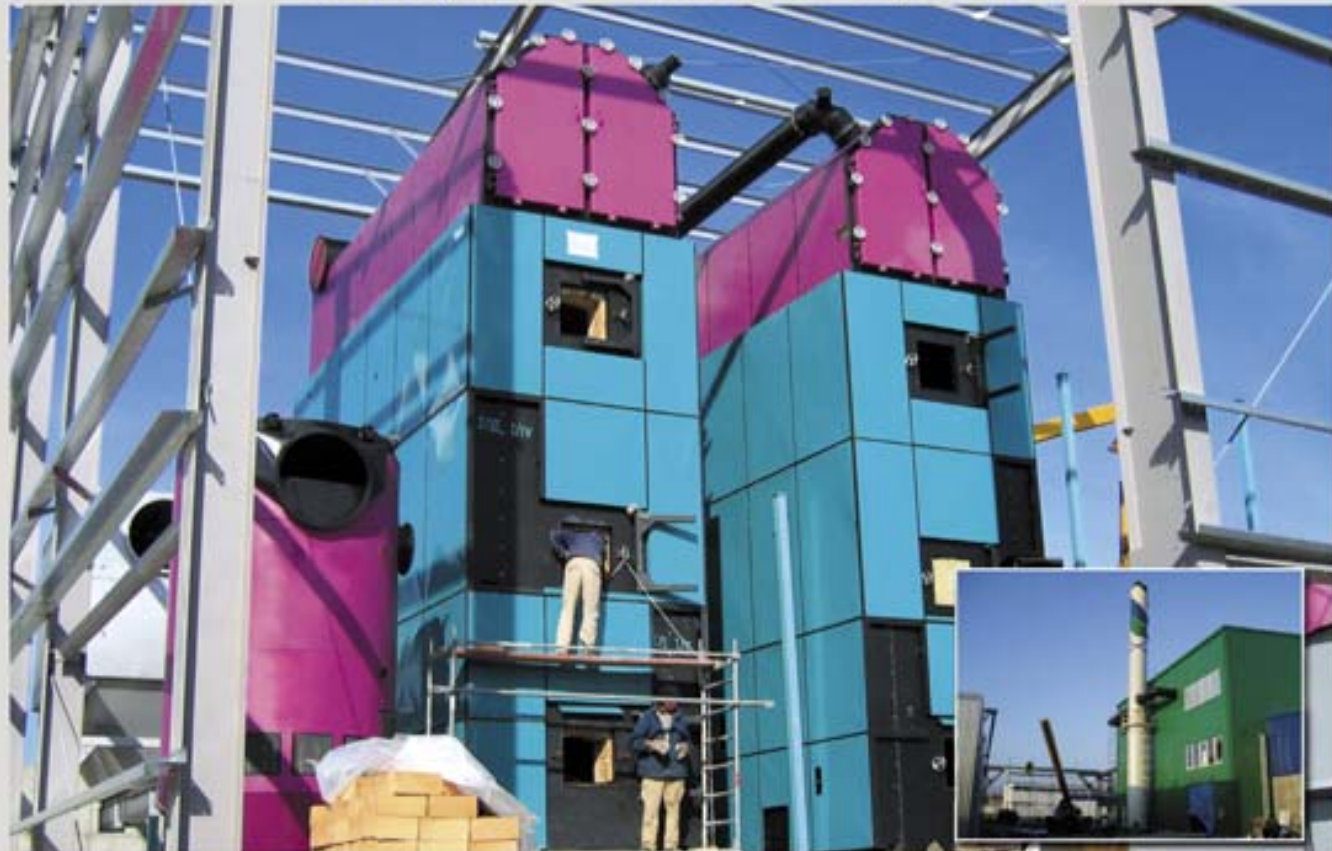
«ЛЕСОБАЛТ» 3x6.000 кВт котельная с гидравлическими механическими колосниковыми решетками
