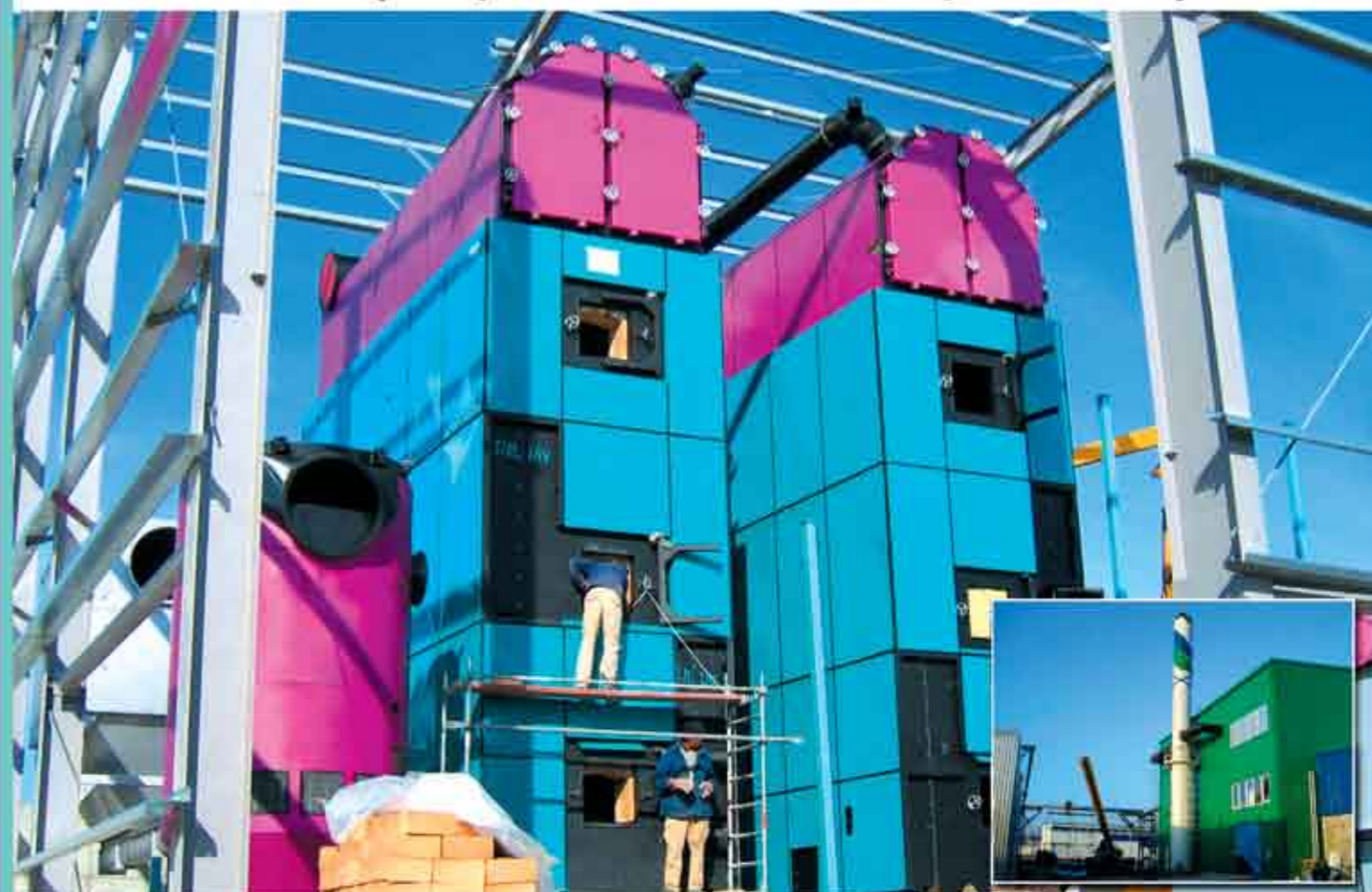
«ЛЕСОБАЛТ» 3х6.000 кВт котельная с гидравлическими механическими колосниковыми решетками
