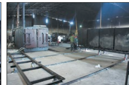
Рис. 18. Установка УП. Справа вагонетки на рельсовой платформе
