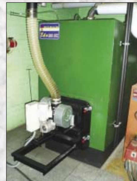
Котел на пеллетах
