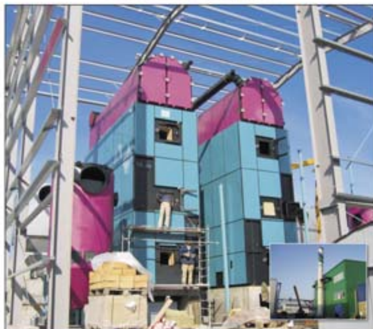
Сооружение котельной 3 x 6.000 кВт с водогрейным котлом высокого давления (120°C) с гидравлической колосниковой решеткой. ЛЕСОБАЛТ/Калининград (Россия)
