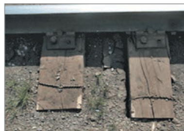
Экспериментальные шпалы, уложенные в главном грузовом пути станции Свердловск – Пассажирский: слева – пропитанная препаратом группы ССА (эксплуатируется 11 лет), справа – креозотом (эксплуатируется 1 год).
