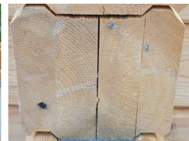
Рис. 5. Разрушение клеевого соединения
